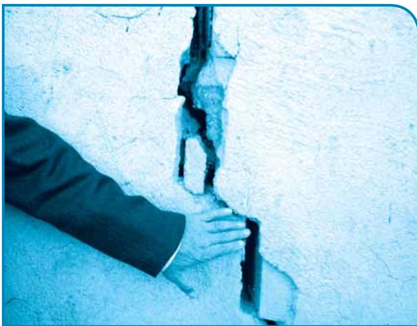
تصویر ۱. شکاف در ساختمان‌های مسکونی، ناشی از نشست زمین
